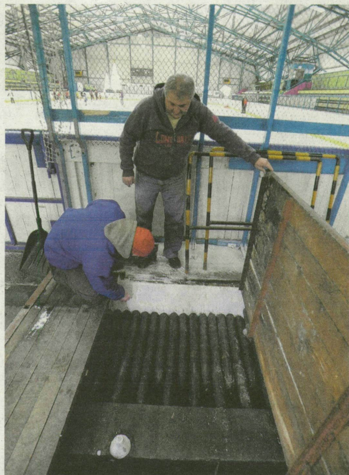
Padlófűtés helyett padlóhűtés.
