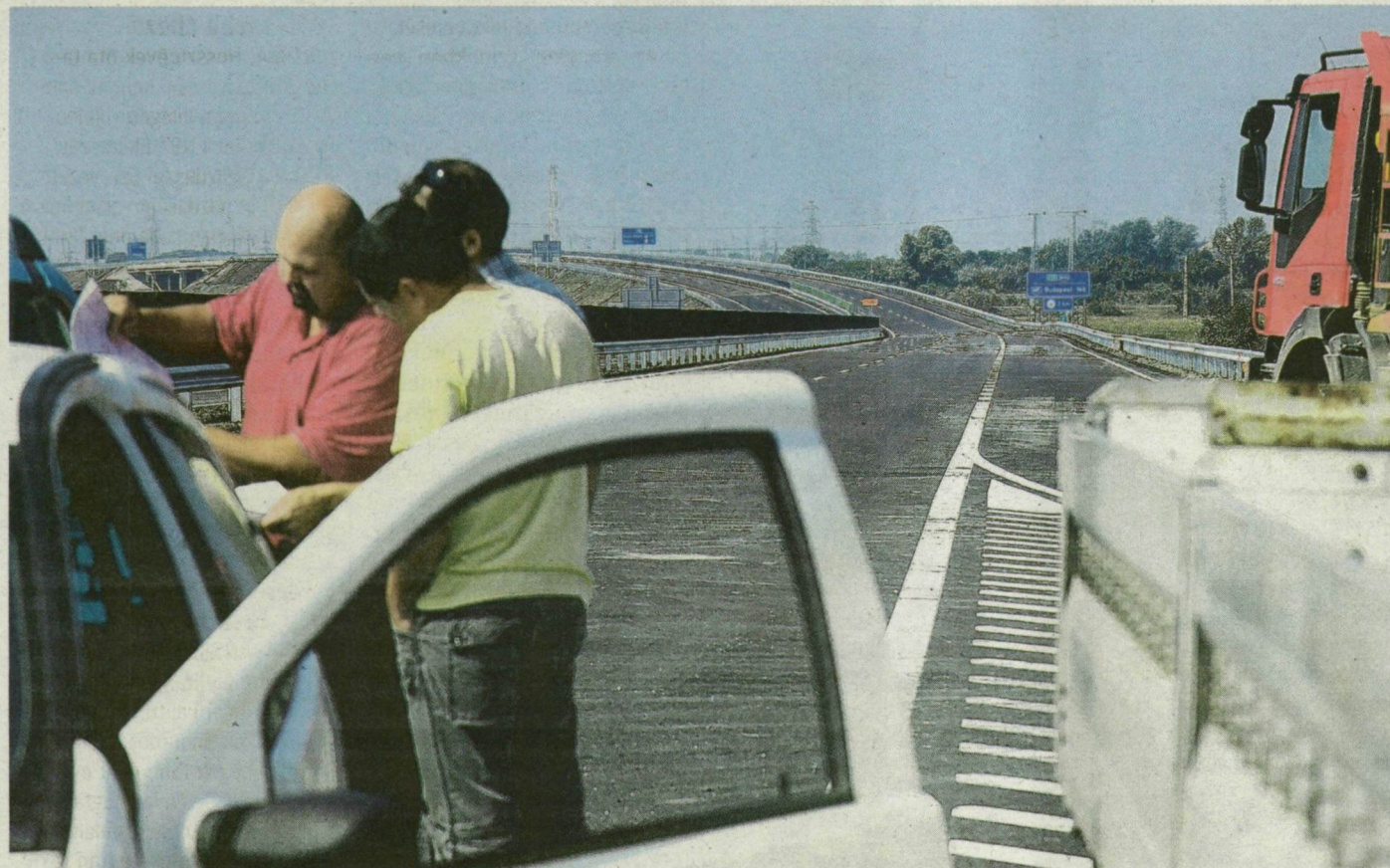
Az M43-as sztráda 47-es útig tartó szakasza majdnem teljesen elkészült. FOTÓ: SCHMIDT ANDREA
