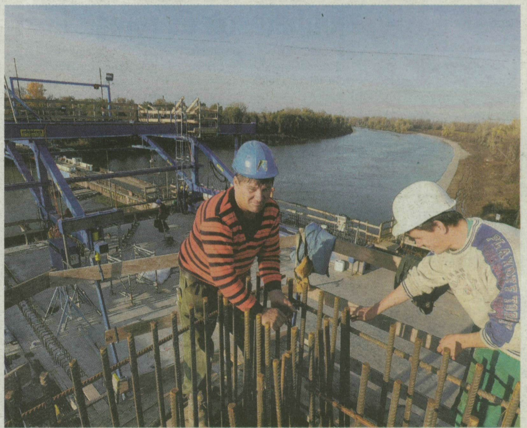
Nagyjából húsz szakma képviselője, száznál is több munkás dolgozik az M43-as híd építésén. FOTÓ: SCHMIDT ANDREA
