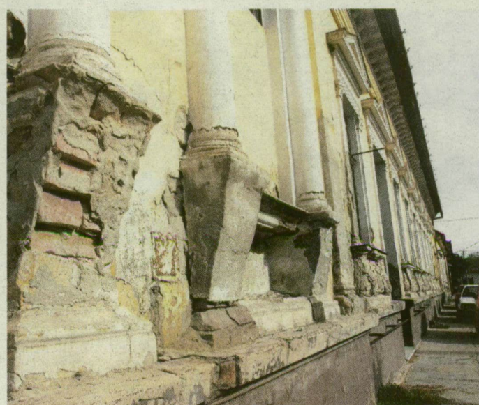
Rohamosan pusztul az épület. FOTÓ: TÉSIK ATTILA
