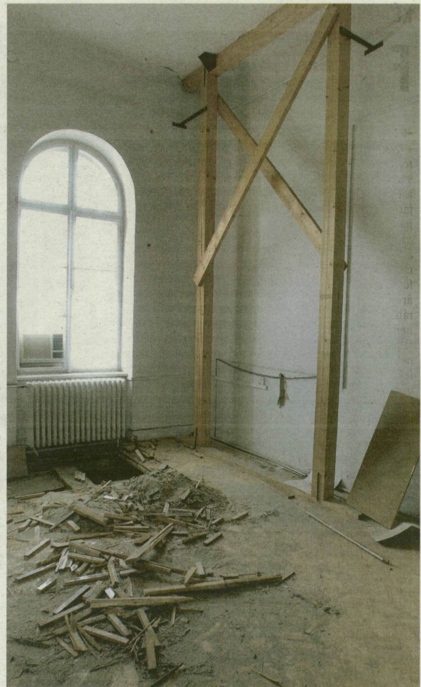
■ A FÖDÉM ELLENŐRZÉSE MIATT KELLETT FELTÉPNI A PARKETTÁT
