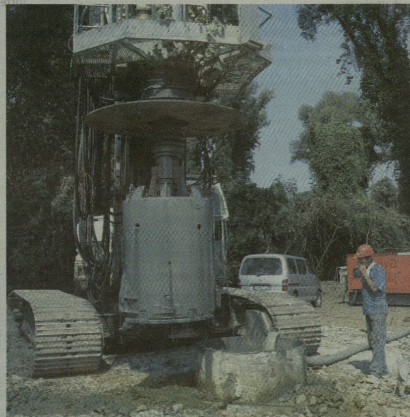
■ ELKEZDTÉK A CÖLÖPÖZÉST AZ ÚJ TISZA-HÍDNÁL - Tegnap óta dolgozik az a hatalmas gép a Tisza árterében, a leendő Tisza-hídnál, amelyik a próbacölöpözést végzi. Ezzel voltaképpen elkezdődött az M43-as sztráda építése. Összesen tizenöt cölöpöt engednek le 35 méter mélyre, a berendezés ezek helyét fúrja ki. Napi egy cölöp „levere” fér bele a kapacitásába. Fotó: Miskolczy Róbert
