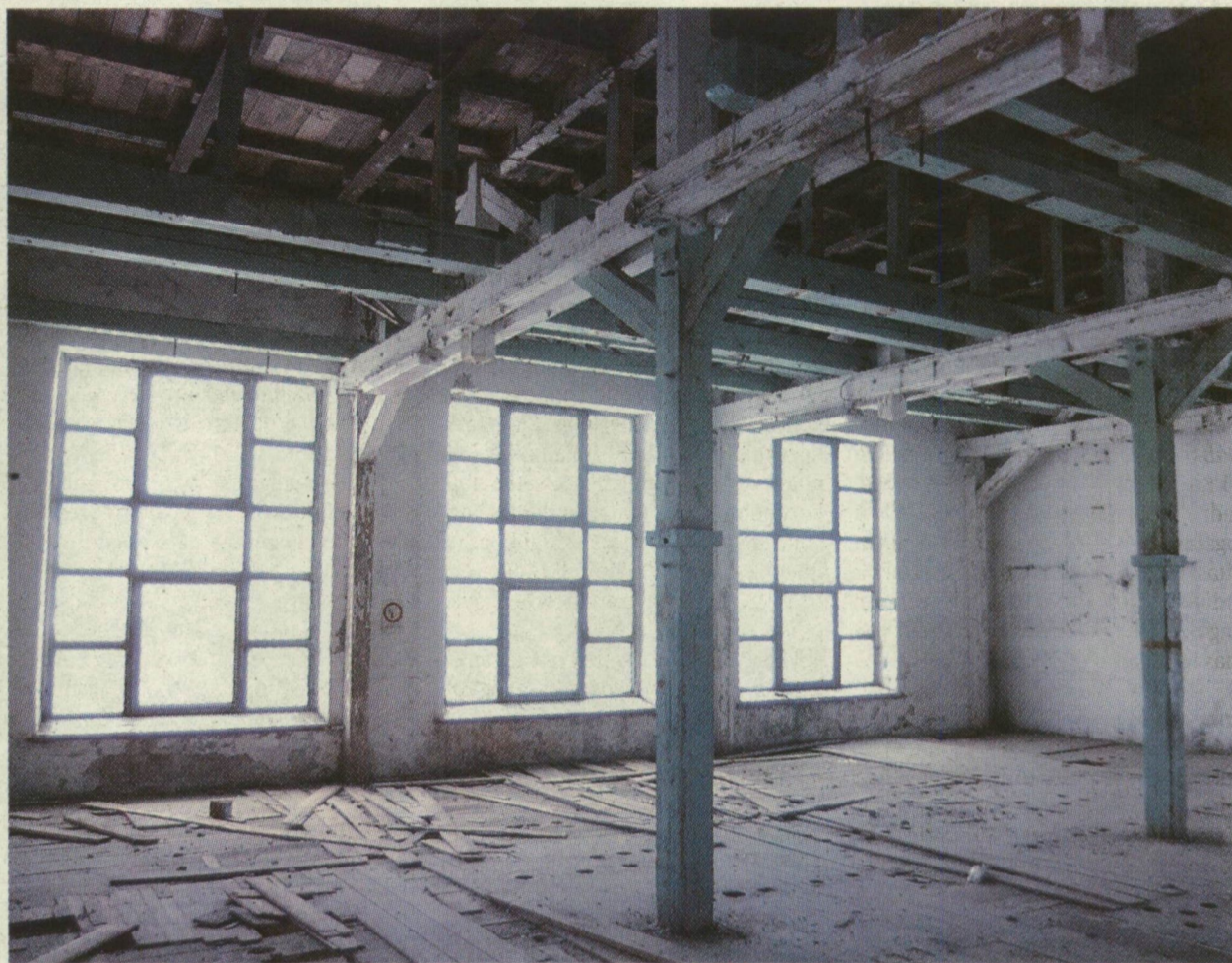
■ A TISZA MALOM BELÜL. ALAPOS FELÚJÍTÁSRA SZORUL AZ ÉVSZÁZADOS ÉPÜLET
