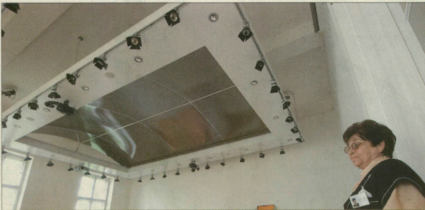
Álmennyezetbe építették be a supermodern világítást
