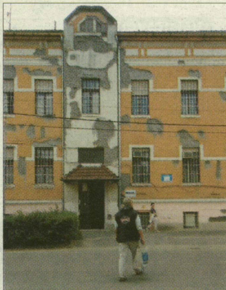
A Pulz utcai épület katasztrofális állapotban van
