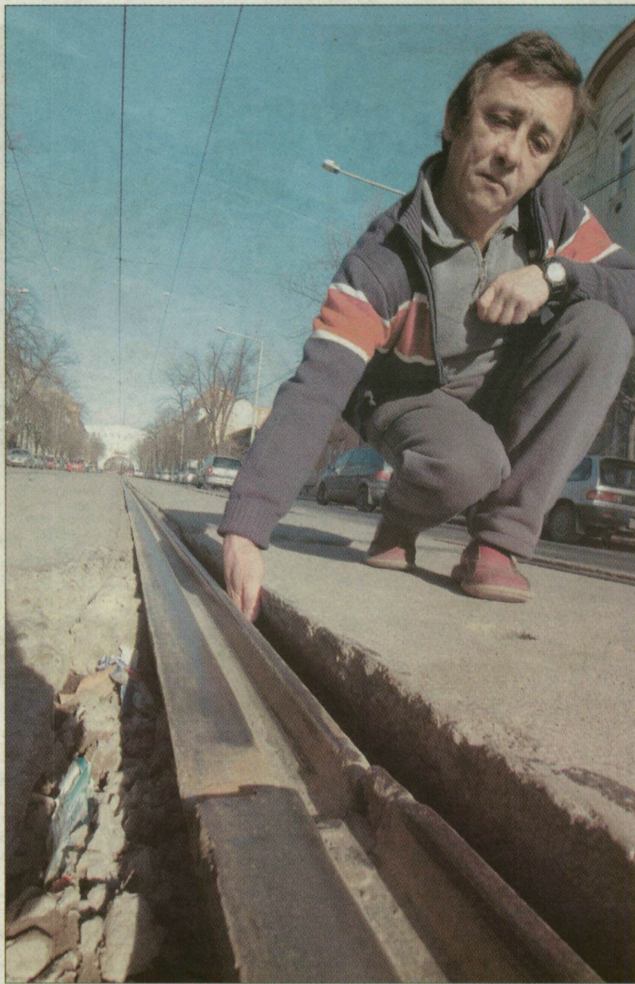
Gyányi István azt mutatja, a törött sín melletti betonpanelek közül hiányzik a kitöltő anyag
