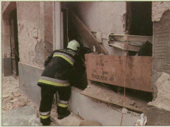
Tűzoltók bontották ki a beomlott épületrészt
