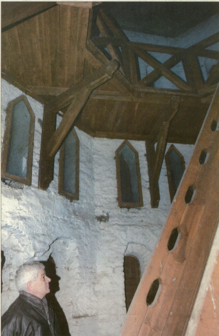
A falak átnedvesedése nem új keletű probléma
