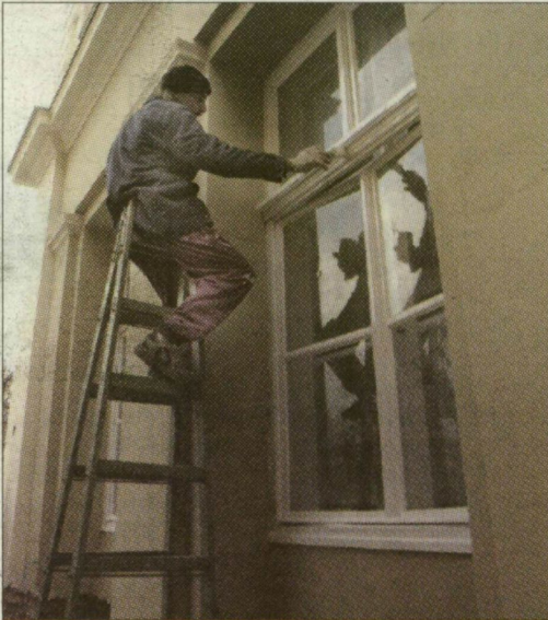
A beázás után igyekeznek gyorsan helyreállítani a szürke épületet
