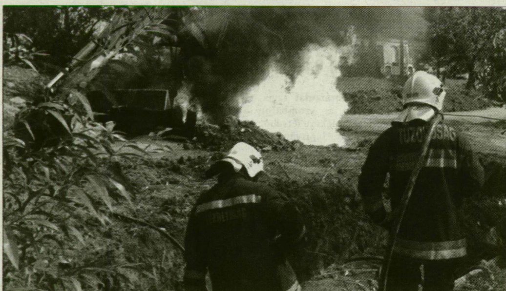
Legutóbb a szőregi csatornaépítésnél történt baleset
