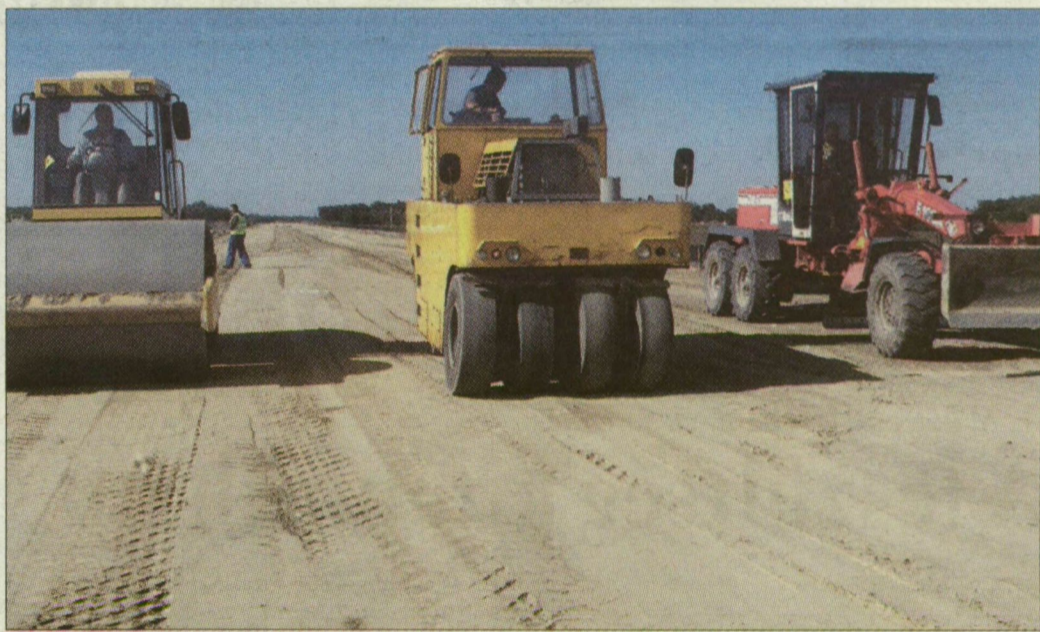
A balástyai lehajtónál. Már a teljes földmunka elkészült 18 kilométeres szakaszon. Fotó: Miskolczi Róbert
