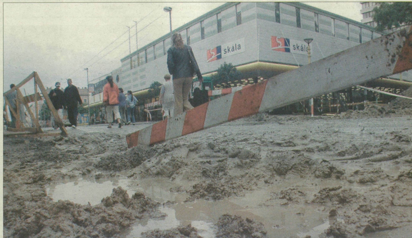
A Tisza Lajos körút látványa tegnap háborús állapotokat idézett. Az építők nem dolgoztak a sár és a víz miatt
