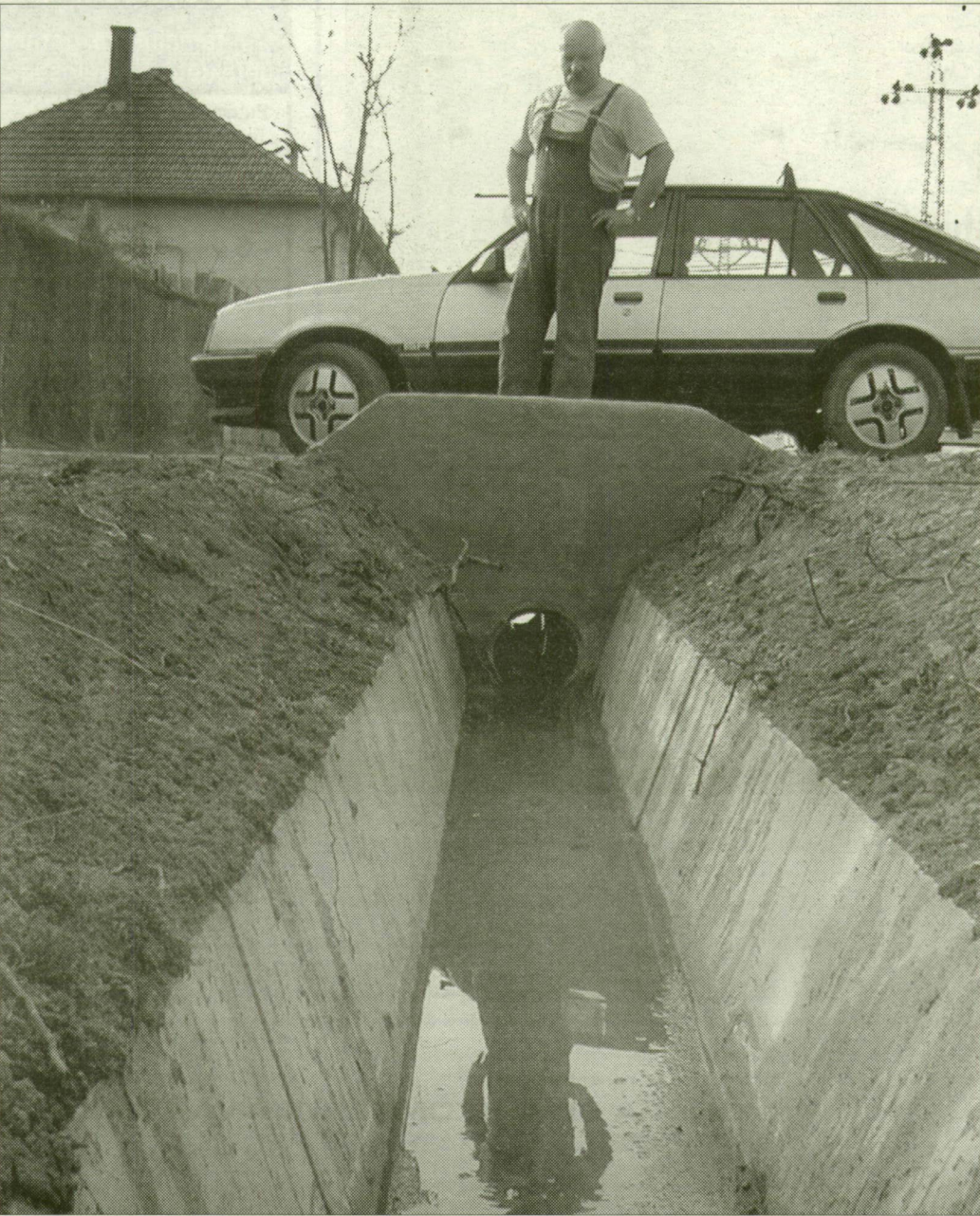
A szakemberek komoly hiányosságokat tártak fel a csatorna építésével kapcsolatban. A felvétel a Budai Nagy Antal utcában készült Tápén. Fotó: Karnok Csaba
