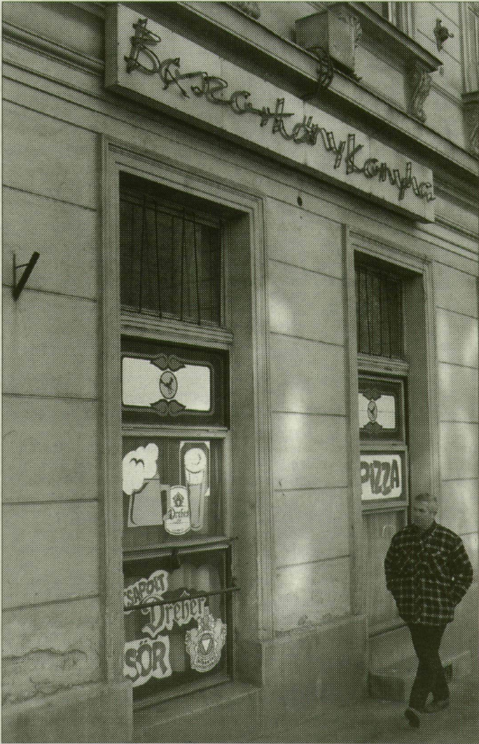
A volt Boszorkánykonyha Híd utcai épülete régen megérett a tatarozásra.
