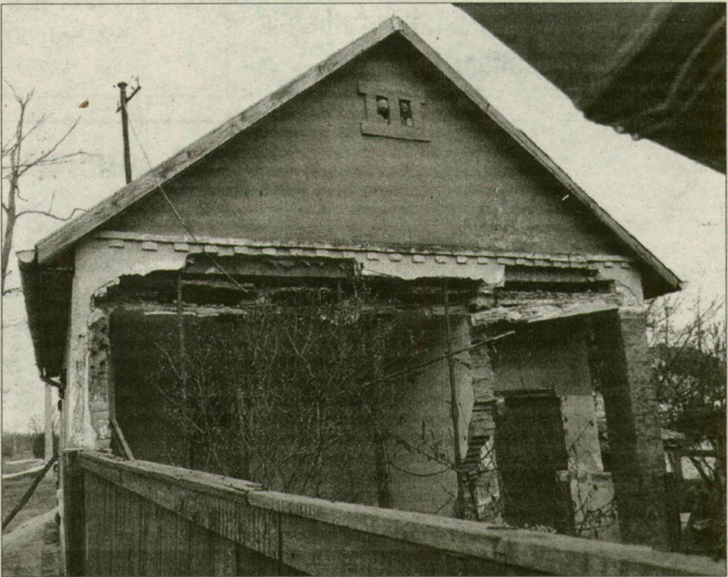
A fal kidőlt, az épületben lakó nő az igazak álmát aludta. Az ijedtségen kívül „csak” anyagi kár keletkezett.
