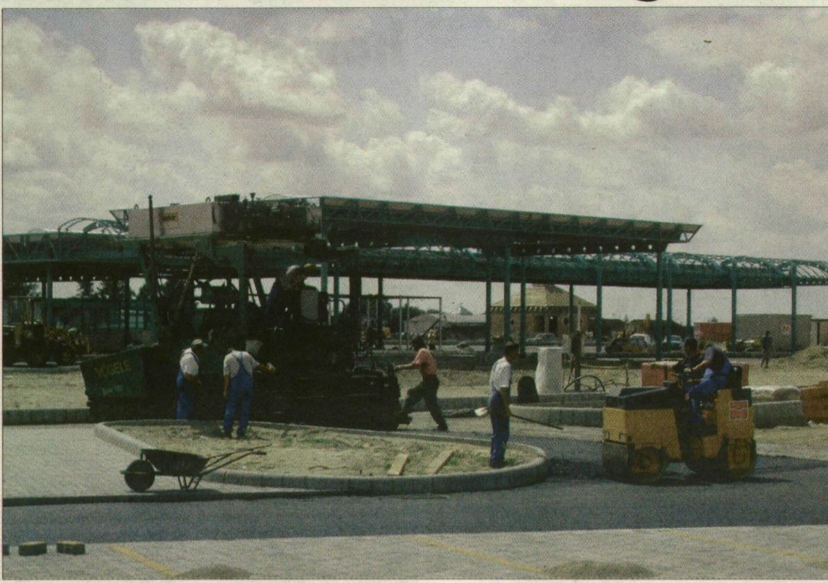
Hetvenezer négyzetméternyi utat borít majd aszfalt a sztrádára váró határátelőkön. (Fotó: Karnok Csaba)
