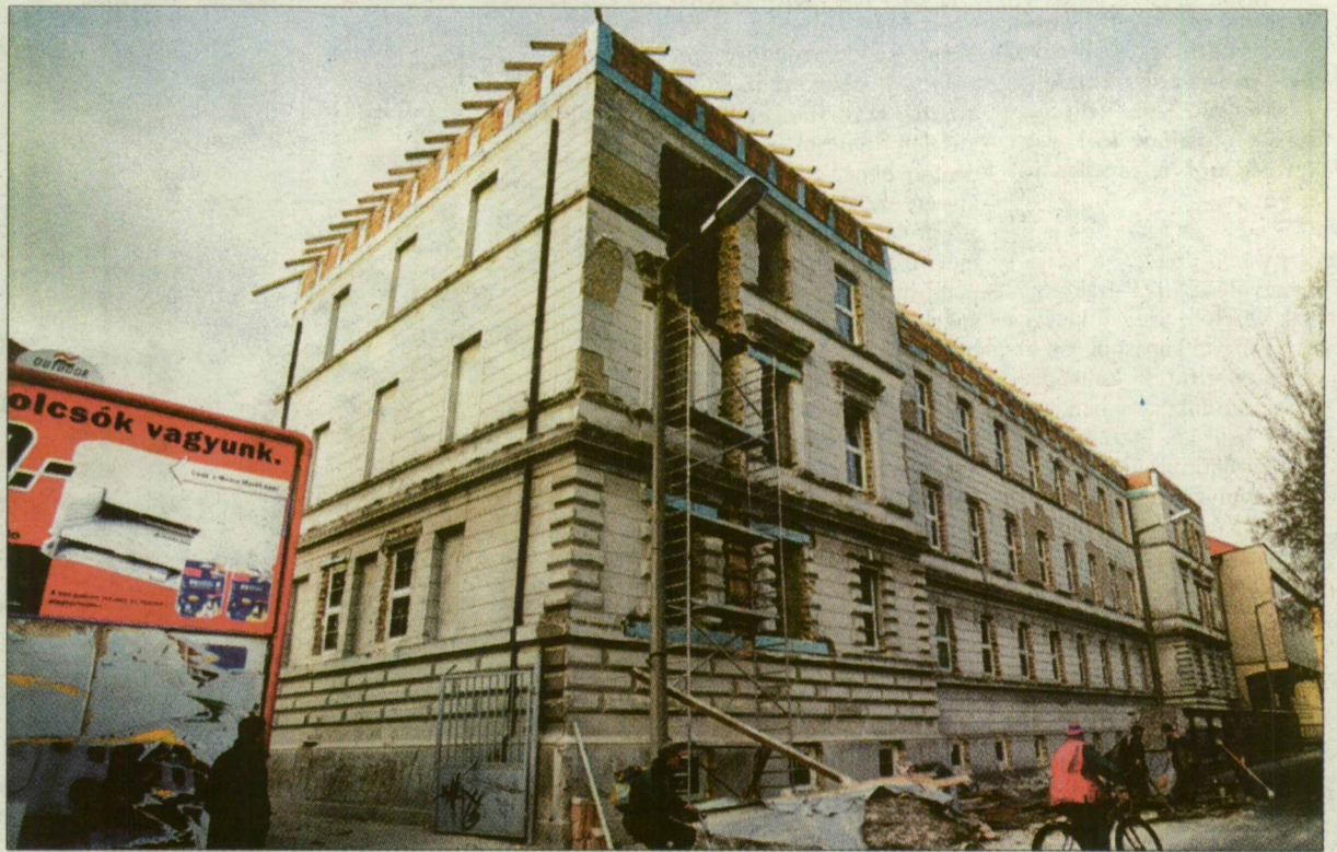
Téglaomlás után. A Gábor Dénes szakközépiskola épületszárnyának fölüjtására hirdetett versenyben is hibát találtak. (Fotó: Gyenes Kálmán)
