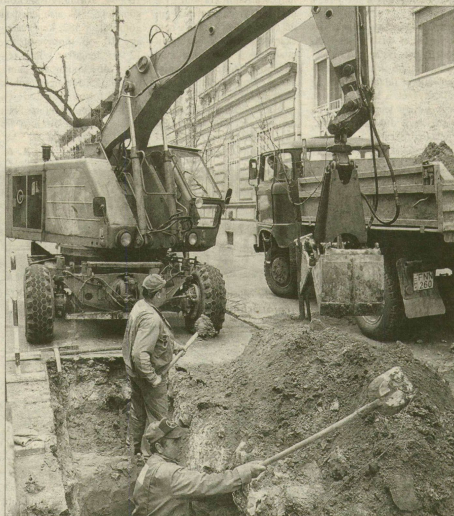
Telített a földgázpiac. Mára már „csak” a javítás, a karbantartás maradt. (Fotó: Karnok Csaba)
