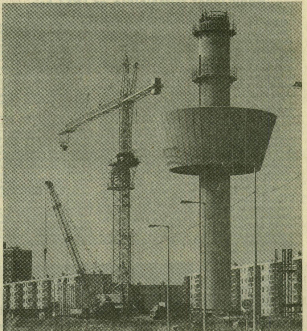
Óriás daru magasodik az épülő szeged-rókusú víztorny mellett, segítségével hamarosan megkezdik a felső víztározó építését. A messziről látható két torony szép látvány az új városrészben, s a munka is érdekesnek ígérkezik a magasban
