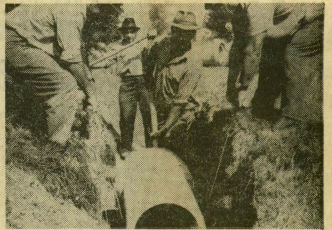
Körmöndi György, Galiba András, Kovács István és Gera Antal sándorfalvi nyugdíjasok az árokba fektetik a betonsöveget
