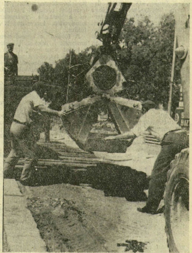
Múlt században épült csatorna fölé kerül az új villamosvágány a Kossuth Lajos sugárút Pacsirta utca és Nagykörút közötti szakaszán. Hogy a vezeték össze ne roppanjon, a MÁV-nál kislejteztet betonlapokat fektetnek föléje. Erre a nagy teherbírási szőnyegre kerülnek majd a 6 tonnás panelek és a vágányok. Ezek fektetését a tervek szerint szeptember 15-én kezdi meg a BKV. Képünkön: markológép segítségével teszik helyére a betonlapokat a Szegedi Magas- és Mélyépítő Vállalat dolgozói.
