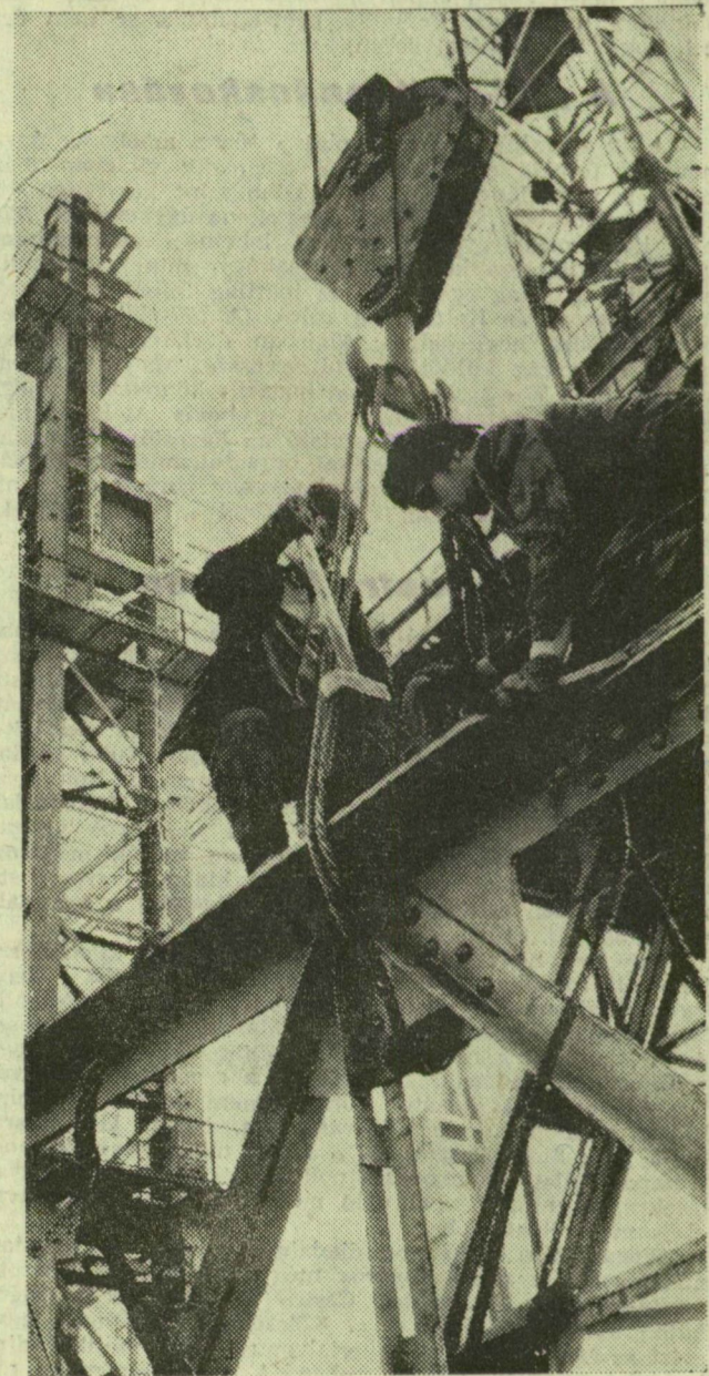
BŐVÜL A VASMŰ. A Dunai Vasműben 1970-ben kezdték meg a folyamatos acélöntőmű építését. Képünkön: dolgoznak a szerelők
