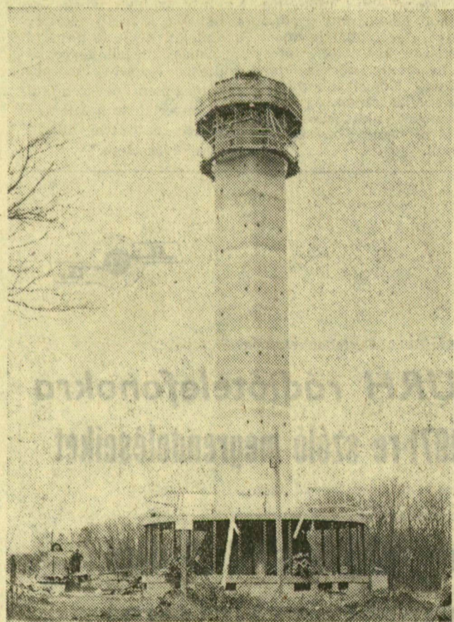
— ÚJ TÉVÉRELE. A Zalaegerszeghez tartozó bazilika tetőn a tévéműsor vételi viszonyainak megjavítására átjátszó reléállomás épül. A torony 68 méter magas beton-törzs lesz. Jelenleg a télmagasságnál tartanak az építők. A 31-es Állami Építőipari Vállalat munkásai csúszószaluzásos módszerrel „húzzák” a tornyot.
