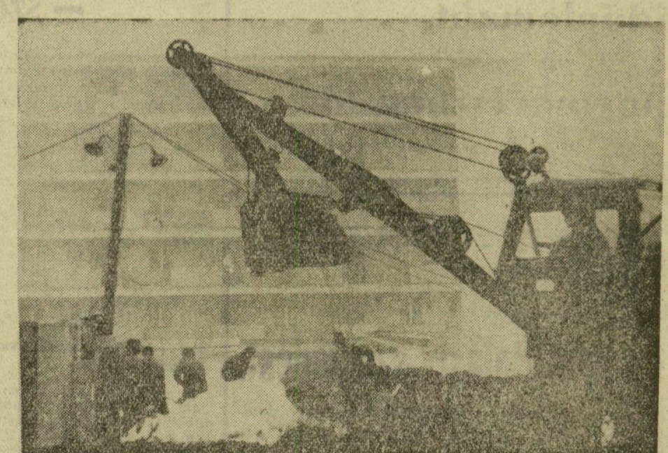
ALAPOZÁS Szegeden a Lenin körút és a Kazinczy utca sarkán beépül a foghíj. Az üres telken új, ötszintes házat emelnek, amelynek falai között 54 lakást alakítanak ki. Az építők jelenleg a ház alapozásának földmunkálatait végzik. Képünkön: az alapozásból kikerülő földet markológéppel mozgatják.
