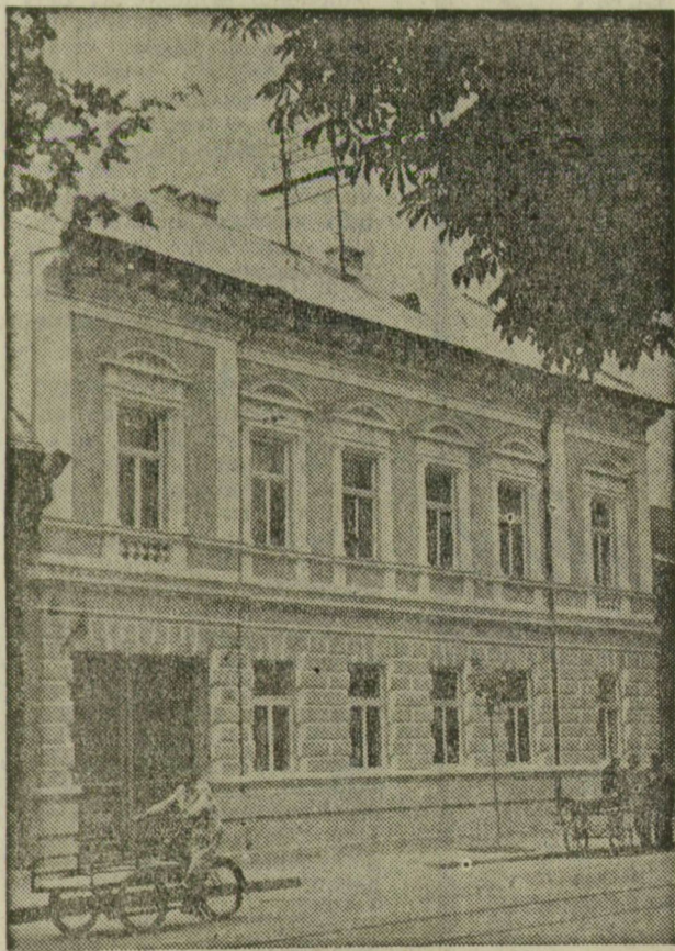
Rohamosan szépül Szeged. Egymásután hozzák rendbe az elhanyagolt házakat. Így történt ez a Toibuhin sugárút 22. számú háznál is. A rozoga ház elcsúfította a környék képét. Az Ingatlankezelő Vállalat felújító részlege komoly, nehéz munkával, 500 ezer forintot költséggel rendbehozta a házat, s annak lakásait. Képünk az újjávarázsolt házat ábrázolja.
